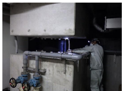
図 85 旧外国人居留地十五番館免振装置と点検状況（撮影協力：株ノザワ）
